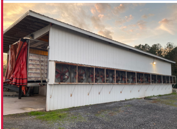
Figura 4.6 Exemplo de instalações de espera adequadas na unidade de processamento.
